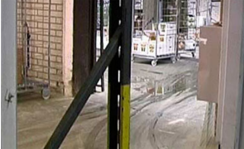
Kuva 4: Varaston lattialle on tullut jostain kosteutta. Kuvan lähde: Turvallisuusjohtaminen logistiikkaketjuissa, opas vahinko- ja tapaturmariskien hallintaan (Vuorinen 2001)
