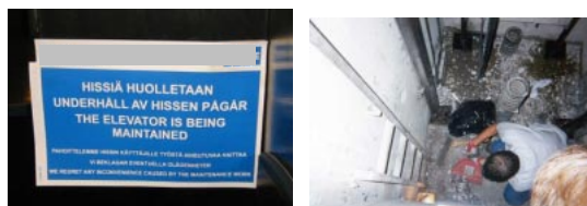
Kuva 12: Huollon ajaksi pitää laittaa ilmoitus asiasta hisseihin. Hissikuilun pohjan puhdistaminen on keskeinen osa huoltoa.
